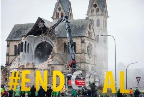
Zerstörung des „Immerrather Doms“
